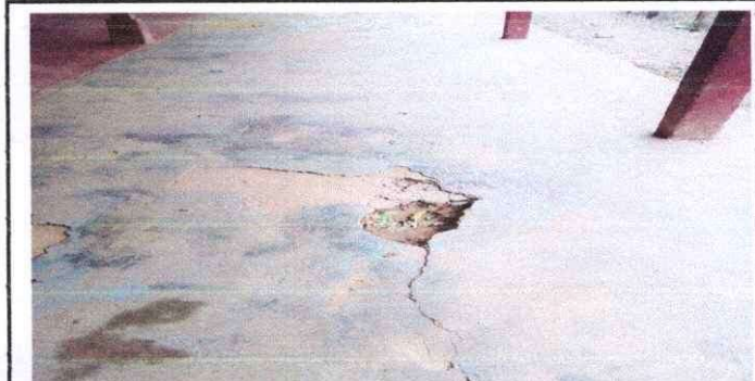
Foto 4: Cambio de entortado, debido a que se encuentra en mal estado.
