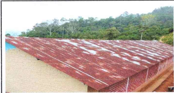
Foto 1: Sustitución de láminas, se observa el deterioro general de la infraestructura.
